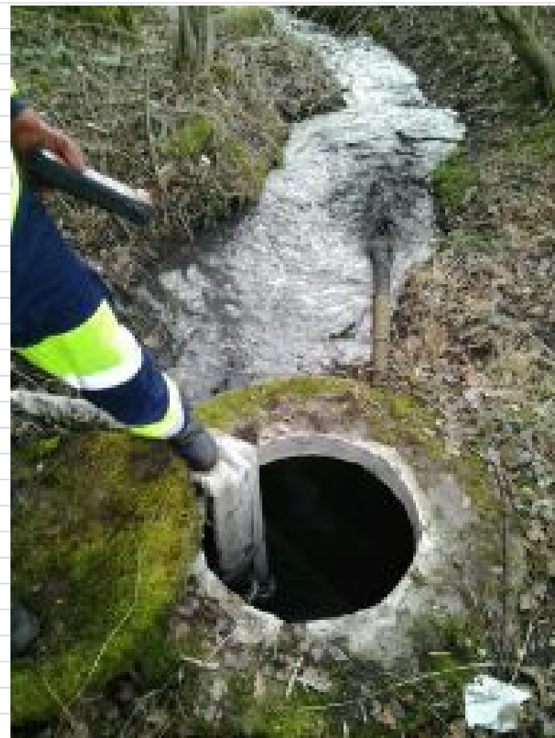
Slamavskiljare med öppen infiltration
